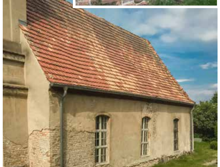
▲ Außenansicht der Alten Dorfkirche von Süden. Der (eigentlich unnötige) Putz platzt überall ab und der Zahn der Zeit nagt am Gebäude.
