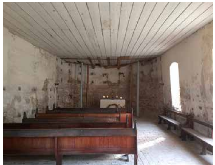
▲ Blick in das Innere der alten Dorfkirche. Man erkennt den steinernen Altarsockel und dahinter die abgestützte Schindeldecke im Chorbereich, die herunterzustürzen droht. Der Altar befindet sich nach seiner Restaurierung im Potsdam Museum. Die Innenwände sind teils unschön verputzt, einige der Fenster nach Norden zugemauert.
